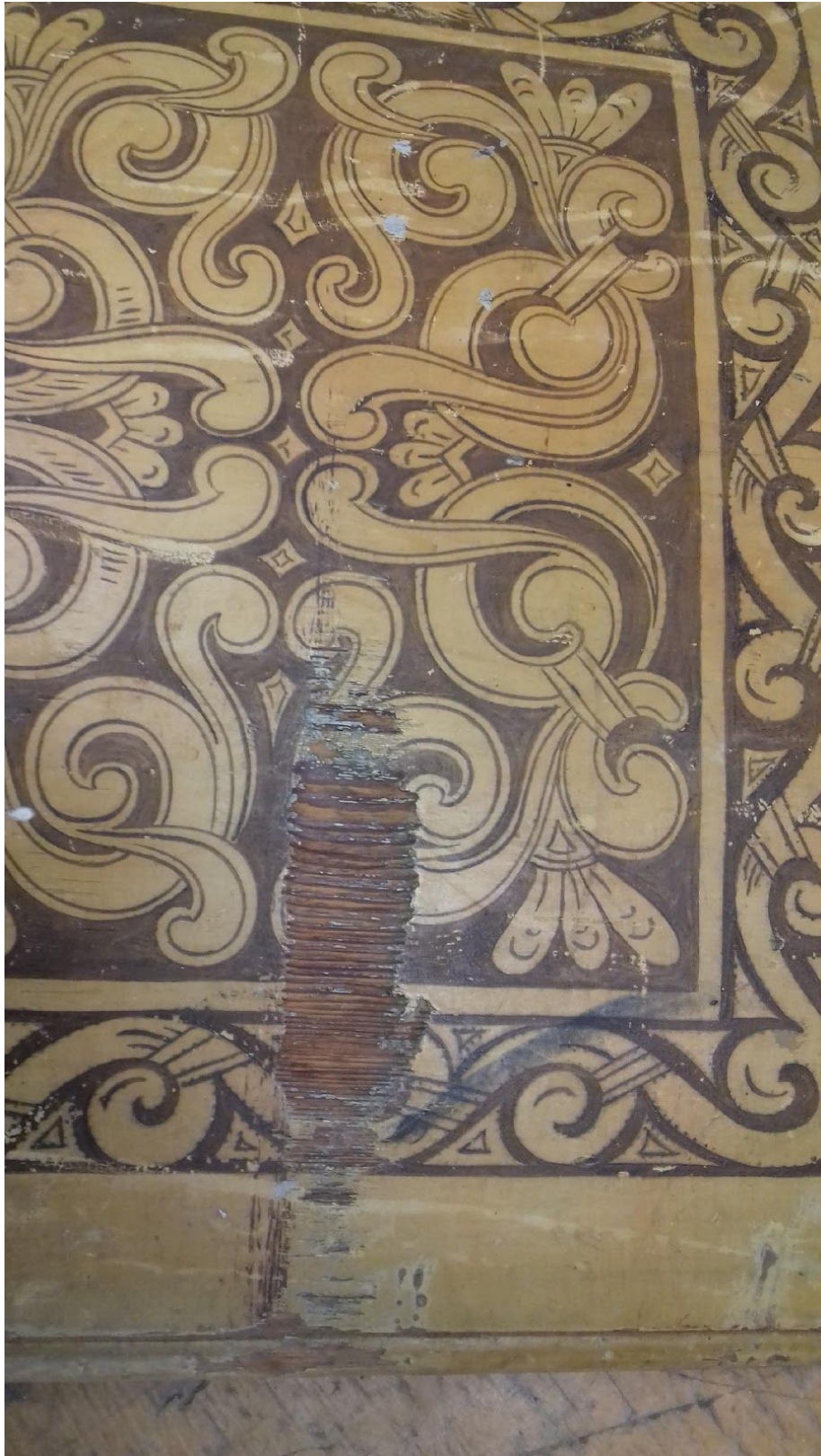
alumise kapi ukse mehhaaniline vigastus
